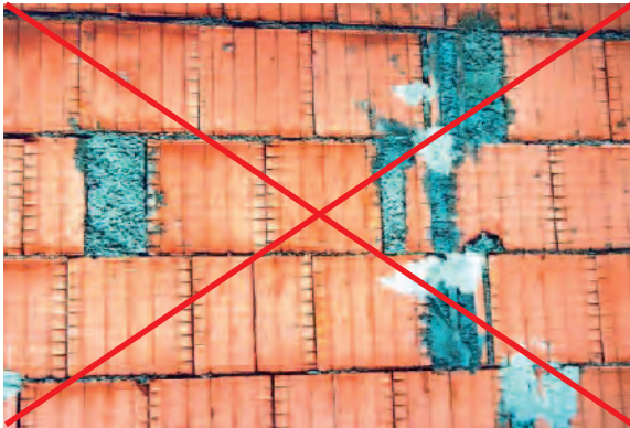
Bild 5.3-3: Regelwidrige Ausführung von Stoßfugen
