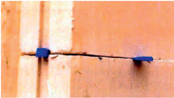
Bild 6.4-1: Unzulässiges Ausrichten von Planelementen mit Keilen
