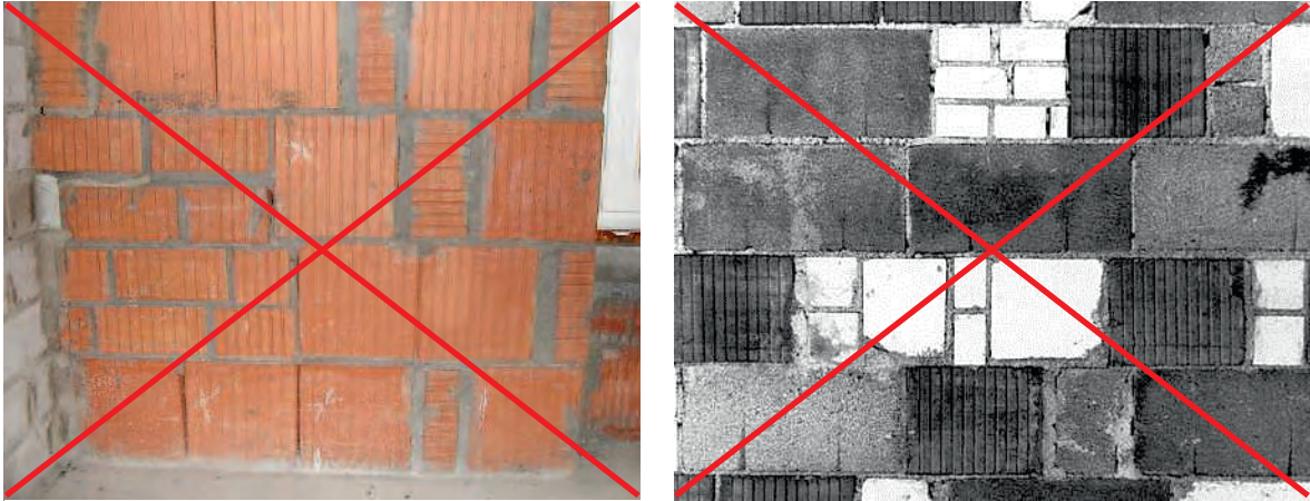
Bilder 5.1-3 bis 5.1-6: Regelwidrig ausgeführtes Mauerwerk
