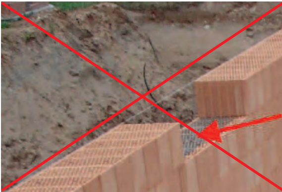
Bild 6.3-6: Regelwidriger Mörtelauftrag nur im mittleren Bereich der Wanddicke [31]
