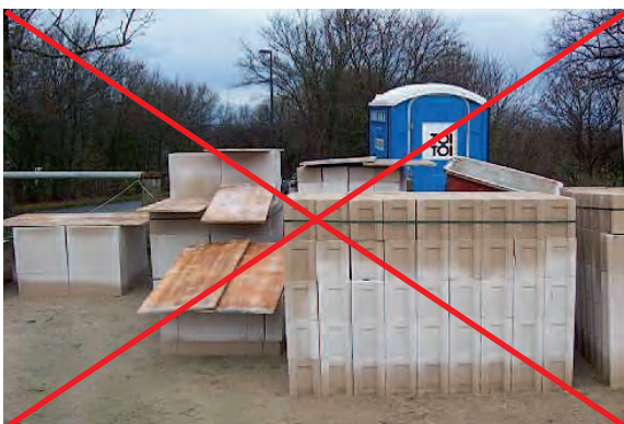
Bild 3.3-1: Mauersteine nicht vor Durchfeuchtung, Bodenkontakt, geschützt
