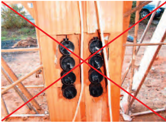
Bild 8-2: Regelwidrige Ausführung von Schlitzten, Aussparungen in einem tragenden Pfeiler (ohne statischen Nachweis), aus [31]
