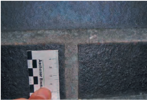
Bild 10.4-4: Ungünstige, rückspringende Ausbildung der Fugenoberfläche
