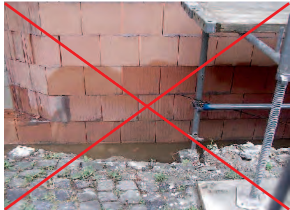
Bild 11-7: Durchfeuchtung von Mauerwerkswänden von unten
