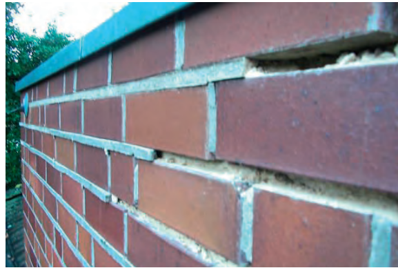
Bild 10.4-5: Schadhafter Fugenabschluss bei nachträglichem Verfugen
