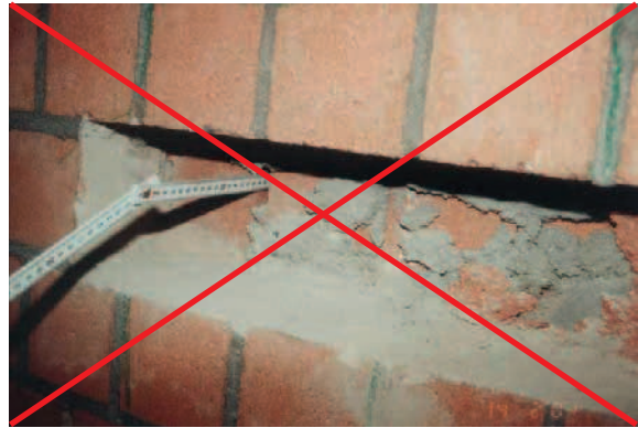
Bild 5.3-4: Verbandsmauerwerk; fehlende Vermörtelung der Längsfuge
