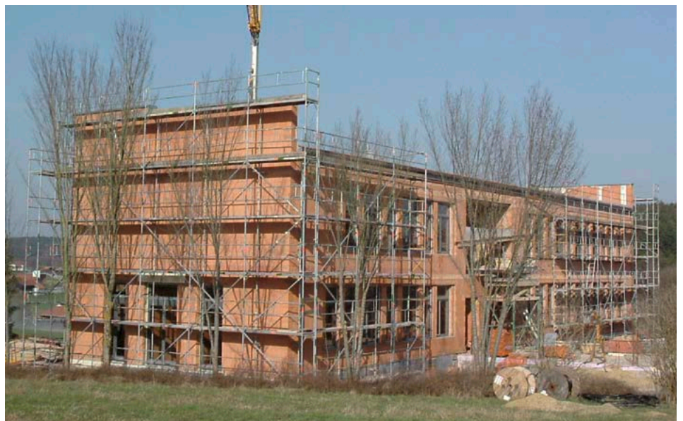
Bild 28. Fassadengerüst, befestigt an einem Ziegelmauerwerk
