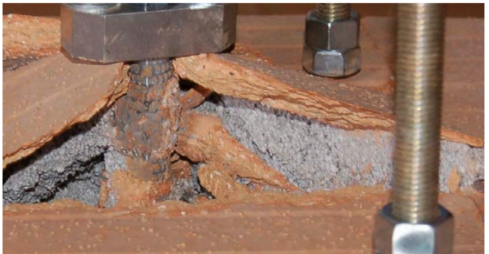
Bild 26. Typischer Steinausbruch bei einem Versuch mit einem Injektionssystem
