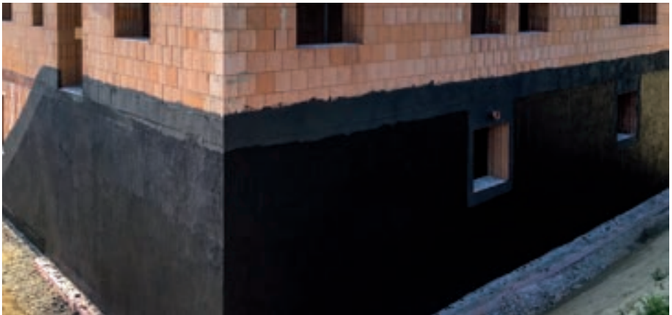
Abdichtung einer erdberührten Kelleraußenwand (W1-E) aus monolithischem Ziegelmauerwerk in Hanglage mit einer kunststoff-modifizierter Bitumendickbeschichtung (PMBC) und im Sockelbereich (W4-E) mit einer mineralischen Dichtungsschlämme (MDS) Ziegellixikon Mauerwerk 2020 ISSN 2193-293X © Ziegel Zentrum Süd e. V. www.ziegel.com
