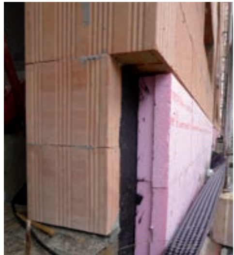
Abdichtung am Wandsockel mit PMBC und Schutzschicht in Form einer druckfesten Sockeldämmplatten und Noppenbahn
