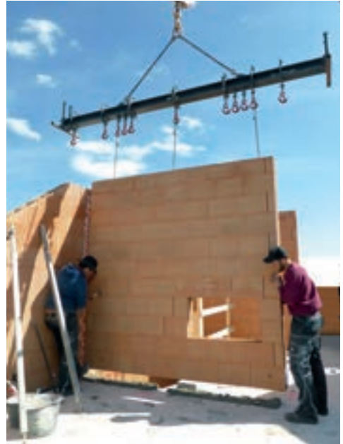
Bild rechts: Versetzen einer geklebten Mauertafel auf Unterlegplatten und Anlegemörtel. Danach werden Montagestützen befestigt und die Bauteilfuge mit Montagekleber verschlossen
