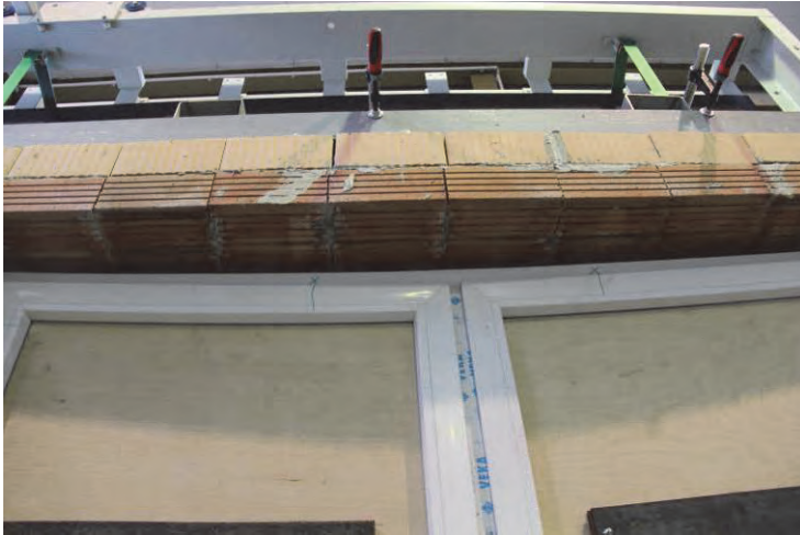
Abbildung 121 Durchbiegung des Fensterelementes
