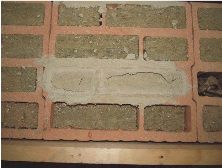
Abbildung 51 Mit Mörtel verfüllter Holraum im Bereich der unteren Befestigung.
