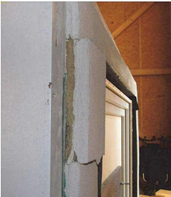
Abbildung 62 Bauteil von außen nach durchgeführtem Pendelschlag
