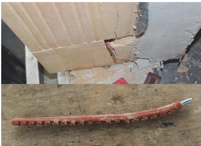
Abbildung 124 oben: Unterer Befestigungspunkt nach Ausbau des Elements unten: Ausgebautes, gebrochenes Befestigungsmittel
