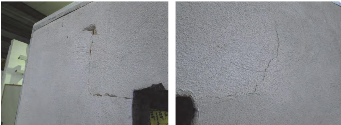
Abbildung 36 Versagen der Lagerfugen im Bereich des Sturzes
