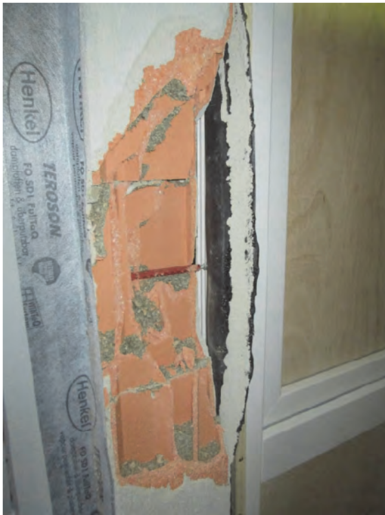
Abbildung 41 Ausbrechen des Leibungsbereiches um den Befestigungspunkt 5
